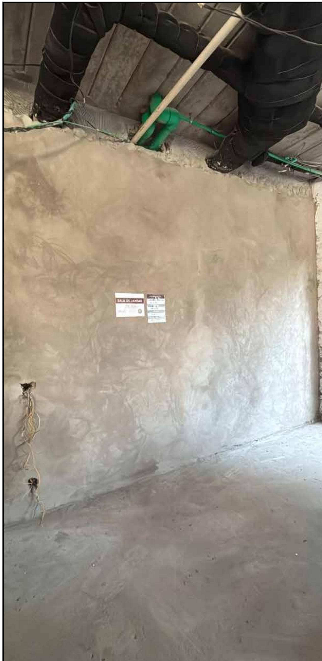
REGULARIZAÇÃO ALVERNARIA SALA JANTAR B
