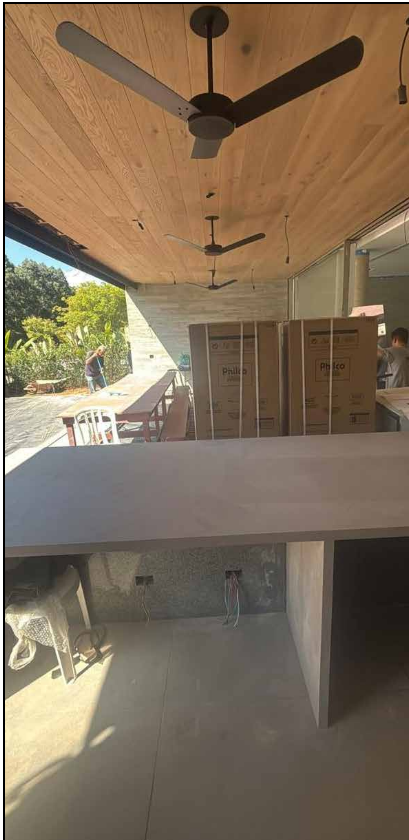
INST.VENTILADORES GOURMET C
